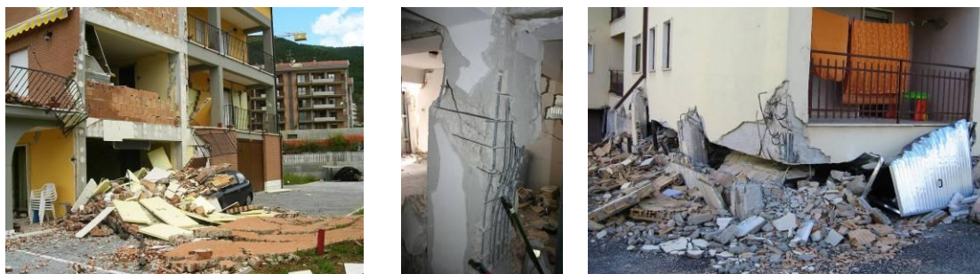
Figura 3: Danos em estruturas de betão armado
