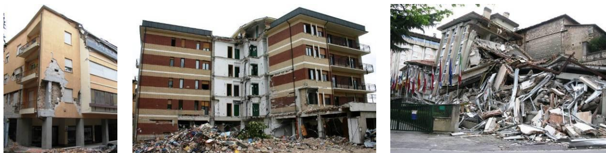
Figura 2: Danos em estruturas de betão armado no centro de L'Aquila
